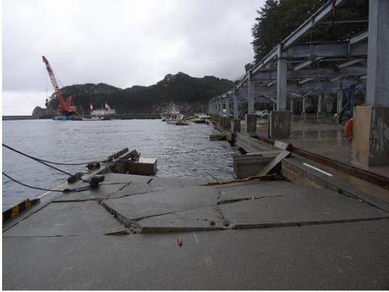
写真1 被災した重茂漁港の水揚げ場 (2011年8月19日)
